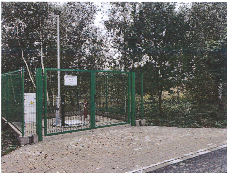
Zdjęcie 9 Kielcza, Przepompownia PK-X, ul. Polna.
