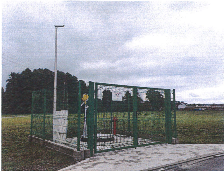
Zdjęcie 8 Kielcza, Przepompownia PK-XI, ul. Topolowa.
